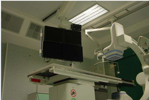
Realizzazione impianti tecnologici per l'installazione di un Angiografo per procedure cardiovascolari diagnostiche ed interventistiche per le esigenze della U.O. di Emodinamica. OSPEDALE DI PESCARA
